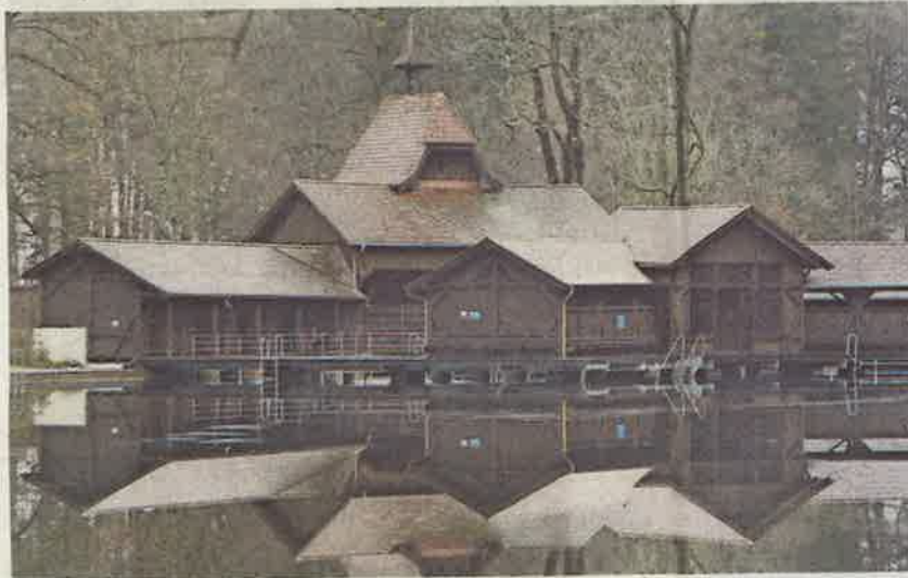
Der Unterbau des Frauenbades auf Dreilinden muss saniert werden.
